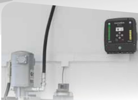
Sala de Bombas
