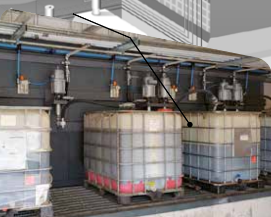
Sala de Bombas
